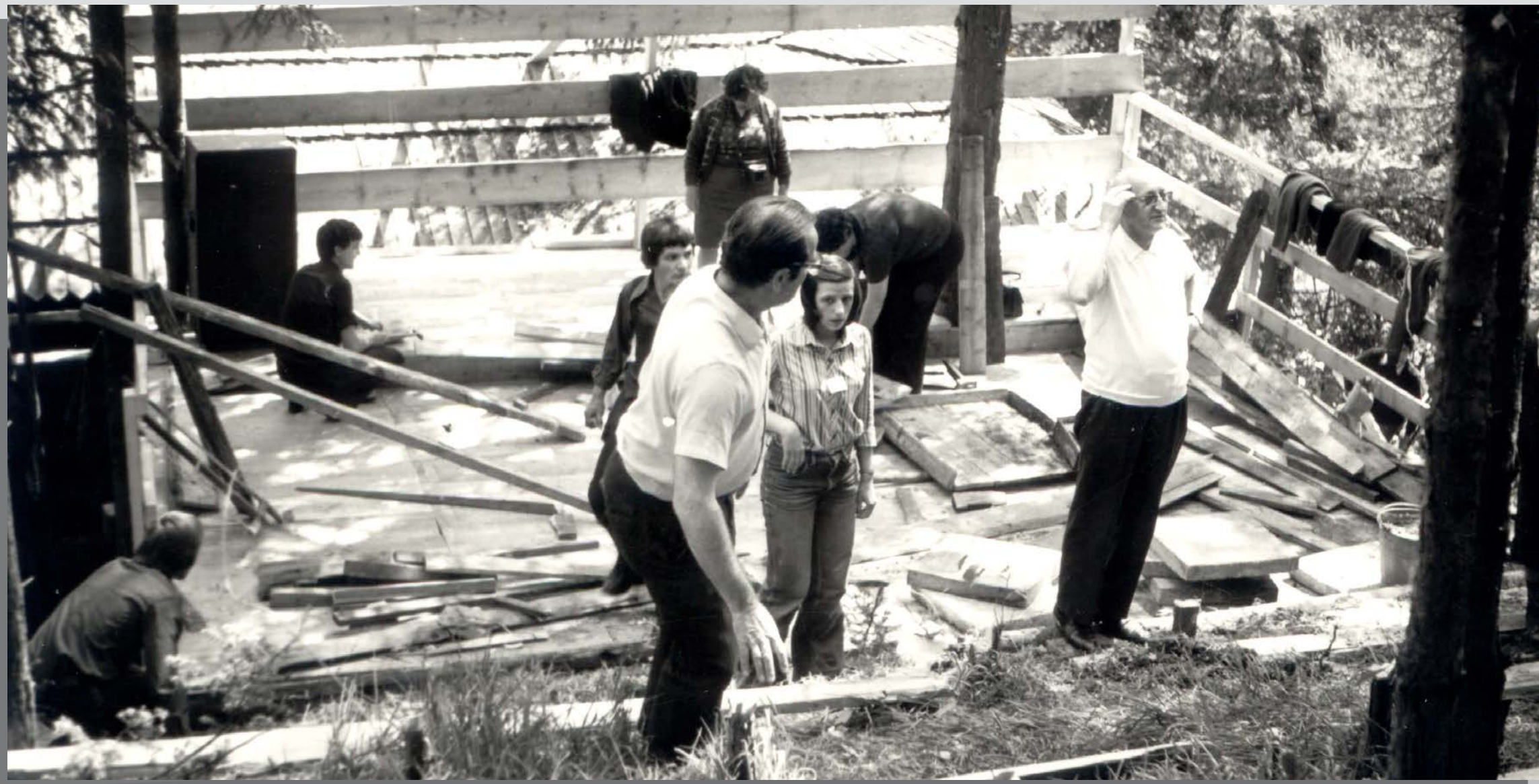
↑ Budowa (mimo zakazu władz komunistycznych) amfiteatru na Kopiej Górze w Krościenku n. Dunajcem, nazwanego potem Wieczernikiem Jana Pawła II, 1979 r. 📷 AGRŚŻ
